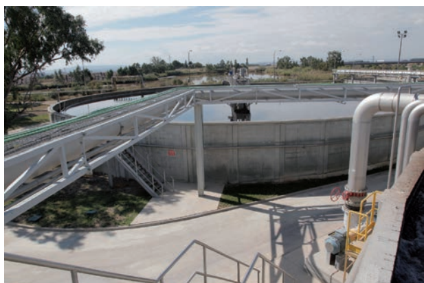
FOTOS 1 y 2. Depuradora con agua
