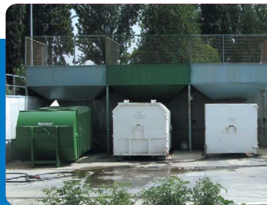
Compactadores en el punto limpio
